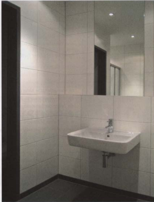
Damit auch die Waschtische und WCs leicht und schnell zu reinigen sind, wurde die moderne Sanitärkeramikserie Renova Nr. 1 Plan mit der Spezialglasur KeraTect in den Spielerbädern und Sanitärbereichen des Trainings- und Geschäftsstellenzentrums installiert.
