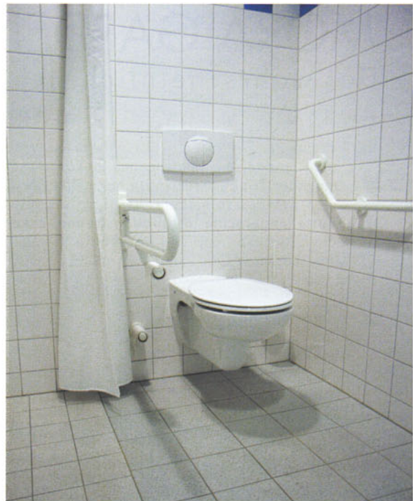
Das wandhängende „Vitalis“-WC hat eine vergrößerte Ausladung von 70 cm. Dadurch ist für den Nutzer das Überwechseln aus einem seitlich neben dem WC abgestellten Rollstuhl erleichtert. Foto: Keramag
