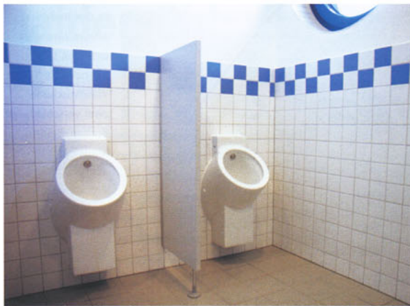
In den Jungentoiletten der Schule wurden „Centaurus“-Hybrid-Urinalen mit integrierter Spüldüse installiert. Für die Spülauslösung sind im Rechner der Gebäudeleittechnik spezielle zeitliche Parameter programmiert. Foto: Keramag
