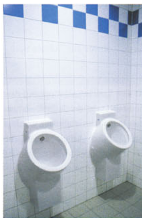
Auch in den Jungen- und Herrentoiletten der Sporthalle sind wassergespülte „Centaurus“-Urinalen vorhanden. Deren einzigartige Form wurde bereits 2004 mit dem „red dot Award“ des Design Zentrums NRW ausgezeichnet. Foto: Keramag
