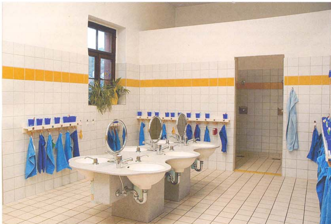
Bild 2 • Das Waschtischensemble ist aus dem Werkstoff „Varicor“ gefertigt. Er ist auch nach der Herstellung einfach zu bearbeiten, so dass individuelle Anfertigungen, die sich jeder Raumsituation anpassen, kein Problem darstellen.
